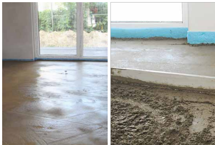
Überwässerter Estrich (zu viel Anmachwasser)
