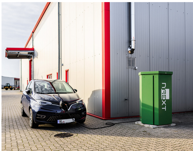
ATEC Energiefluss-Produkte, Neu Wulmstorf: HEXAGON
