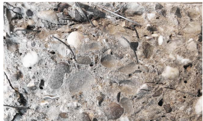
Abb. 5: Rissvernadelung im Stahlfaserbeton
