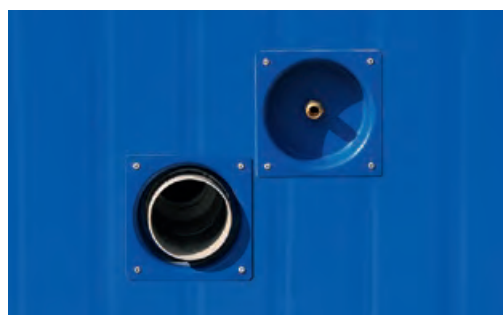
Wasseranschluss, in der Wand versenkt
