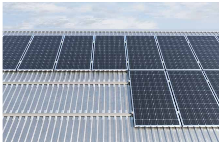
Dach mit Trapezblechdachsystemen
