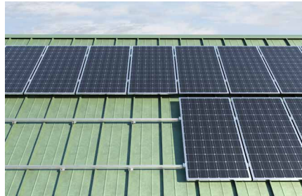
Steildach mit Stehfalz-Eindeckung
