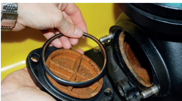
› Prüfung und Reinigung der Rückschlagklappe
