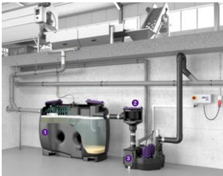
1 Stärkeabscheider 2 Probenahmeeinrichtung 3 Hebeanlage
