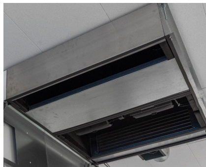
Abbildung 5: Revisionsöffnung für Ventilator und Wärmeübertrager.
