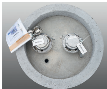
Füll- und Absaugstutzen Pelletspeicher
