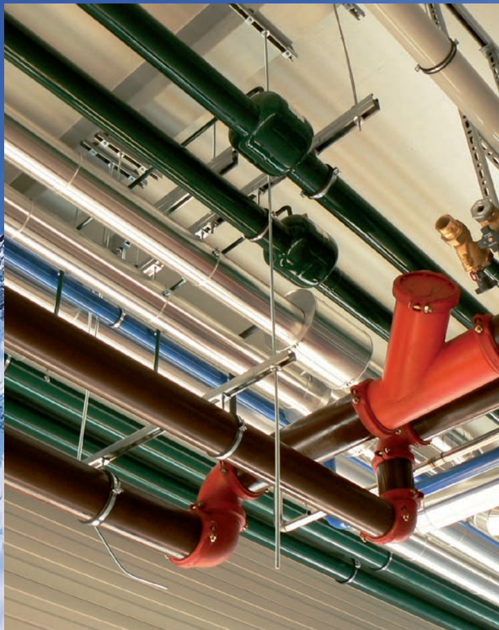
Kühlwasserleitungen CENTUM® Schwerlastsystem und 45er Schienensystem
