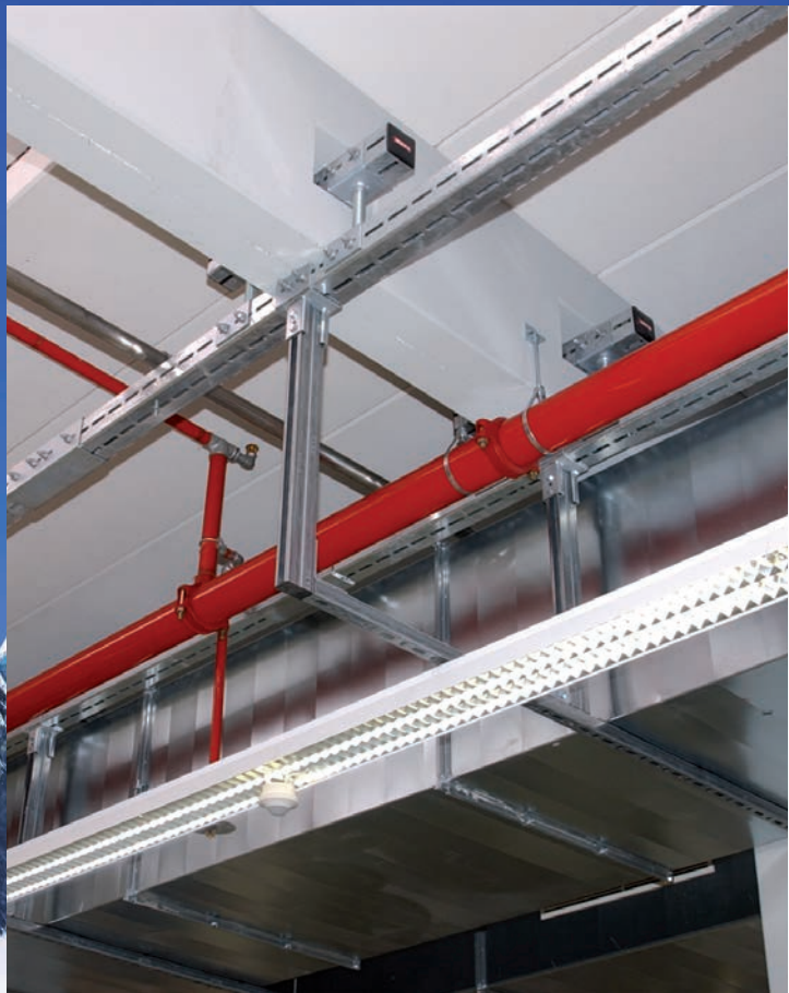
Versorgungsstrasse für Produktionsanlage an Betonunterzüge Montageprofil CENTUM® XL 100 mit Montageschienen System 45
