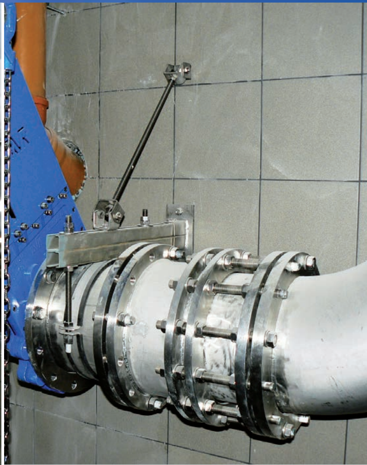
Kläranlage Czajka, Warschau
