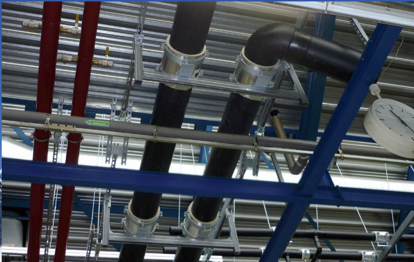
Versorgungsstrasse für Produktionsanlage an Stahlträger Kälteschelle ALU/PU 80 auf Montageschienen System 45 mit Gleitplatte
