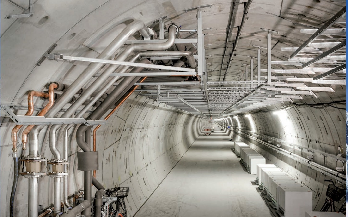
Kühlwasser- und Klimaleitungen Montageschienen System 45 mit Sondergelenkhalter
