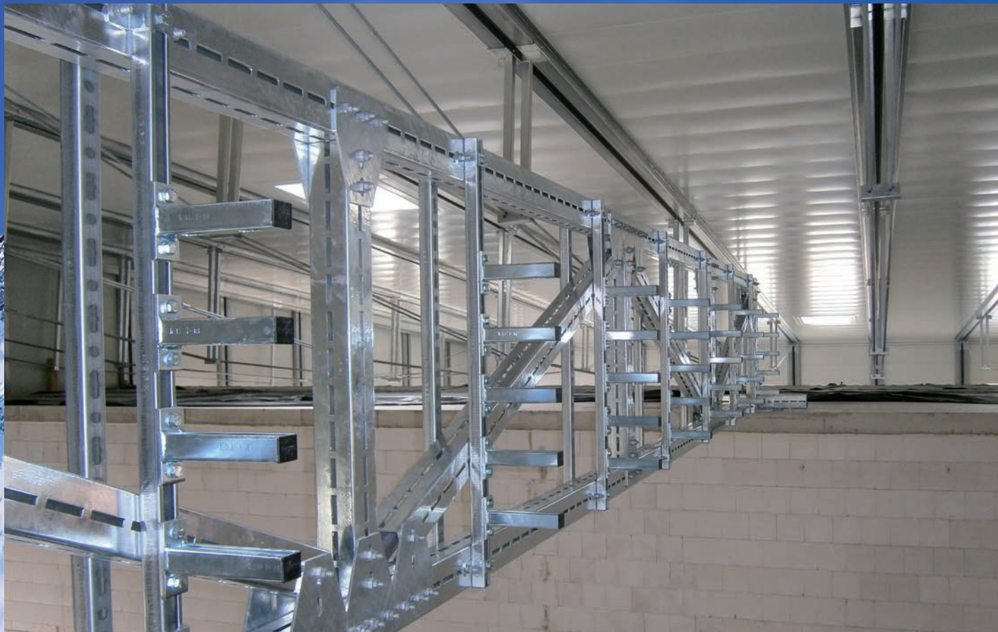
Produktionshalle Lebensmittelaufgaben Montageprofil CENTUM® XL 100 mit Montageschienen System 45
