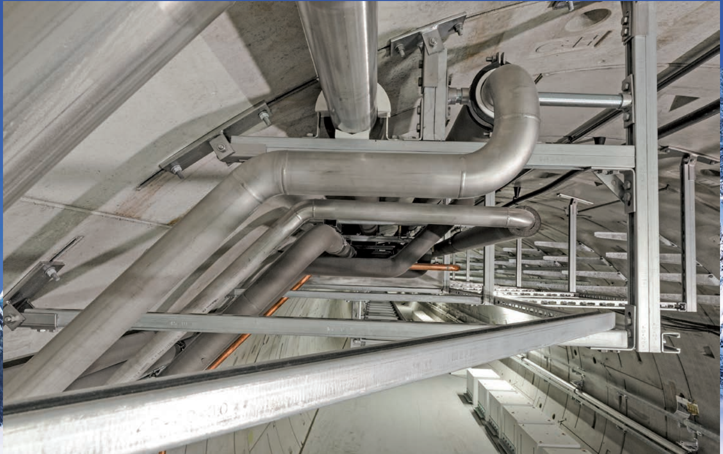
Kühlwasser- und Klimaleitungen Montageschienen System 45 mit Sondergelenkhalter
