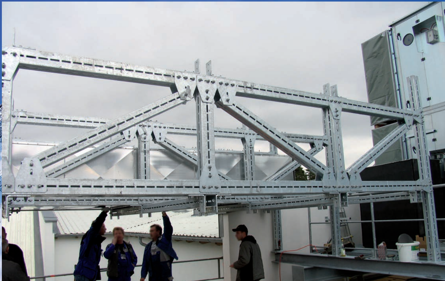
RLT-Anlage auf Dachkonstruktion CENTUM® Schwerlastsystem mit Anbauteilen
