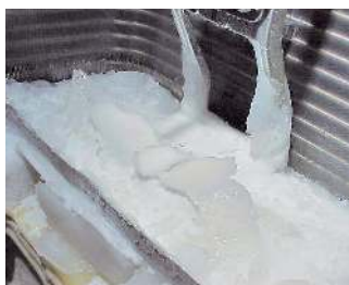
Eisbildung am Außengerät ohne Wannenheizung
