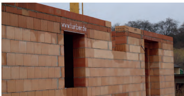
Abb.3 Winterbaustelle mit starkem Feuchteeintritt im Ziegelmauerwerk
