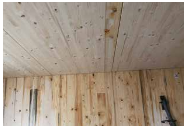
Unschöne Wasserflecken an einer Brettsperrholzdecke
