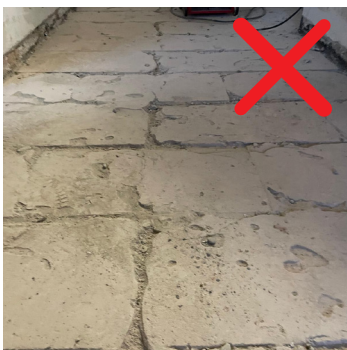
Muss mit standfester Masse repariert werden
