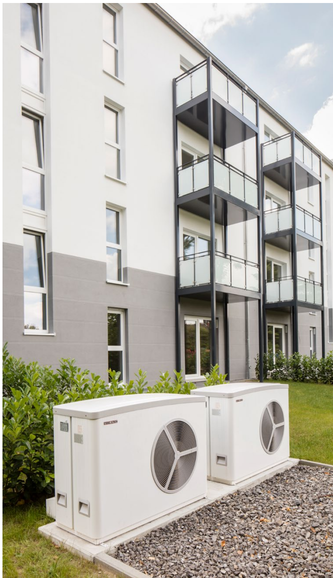
Jedes Gebäude mit neun Wohneinheiten wird von einer Kaskade aus zwei Luft-Wasser-Wärmepumpen WPL 25 A mit Wärme für Heizung und Warmwasserbereitung versorgt.
