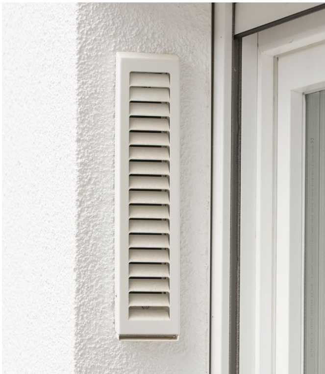
Die Lüftungsöffnungen für die Pendellüfter wurden in den Fensterlaibungen realisiert und sind damit in der Fassade kaum wahrnehmbar.
