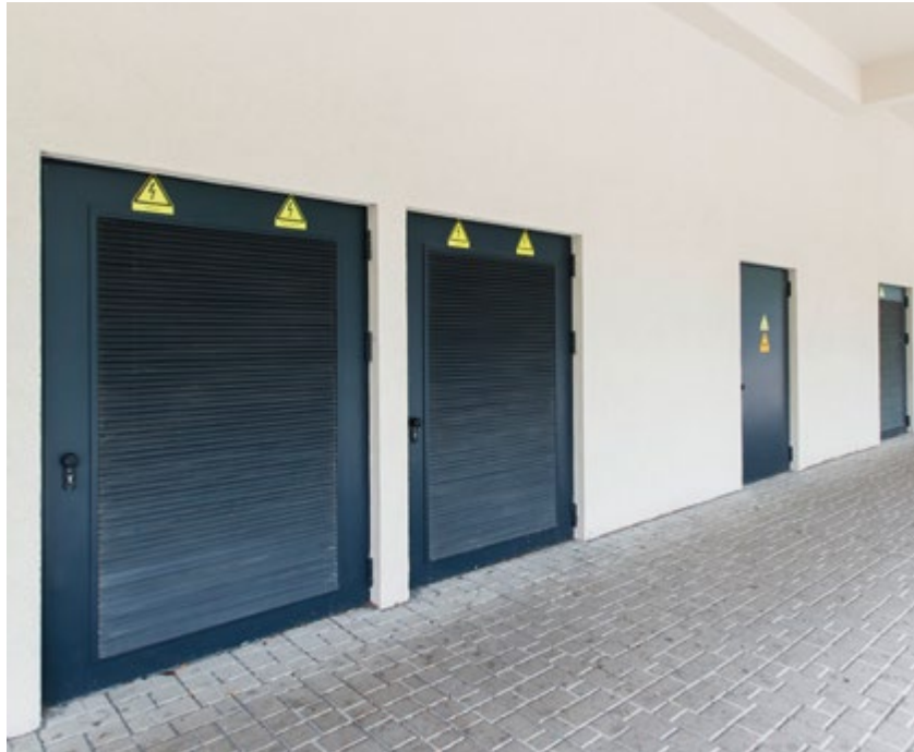
Mehrzwecktür mit Trafogitter
