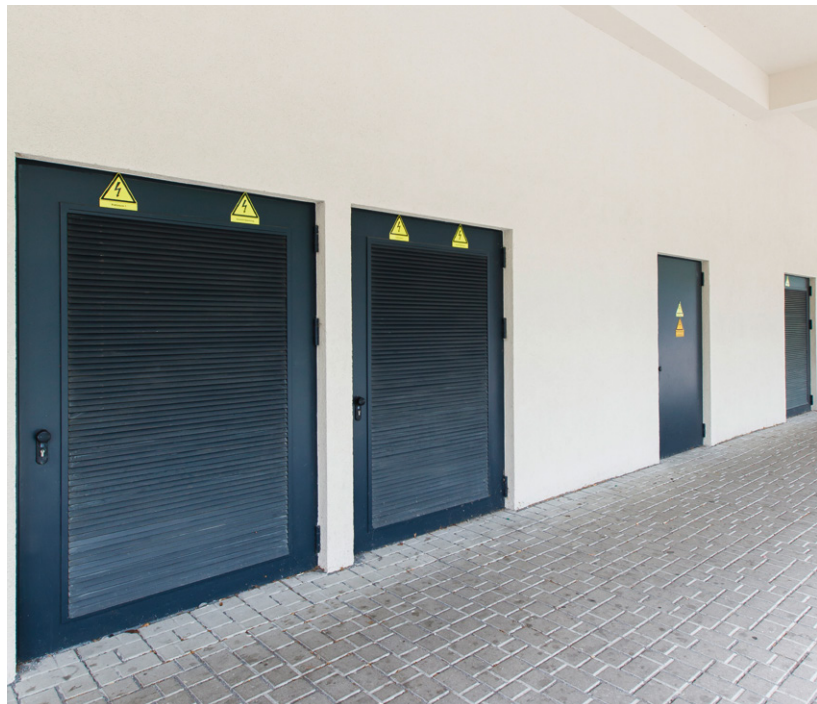
Mehrzwecktür mit Trafogitter
