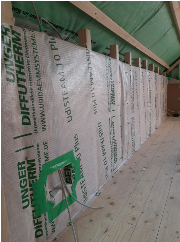
UdiSTEAM® 10 plus im Drenpelbereich
