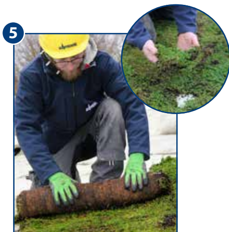
Urbanscape Sedum-Mix Vegetationsmatte ausrollen. Darauf achten, dass alles mit Urbanscape bedeckt ist.
