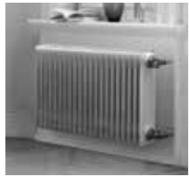
Vorher: Alter Heizkörper
