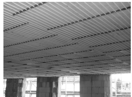
Abb.4: Deckenheiz-/kühlsystem in der Putzschicht integriert
